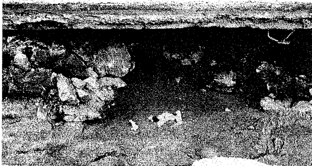
Presenza acqua proveniente dal terreno
